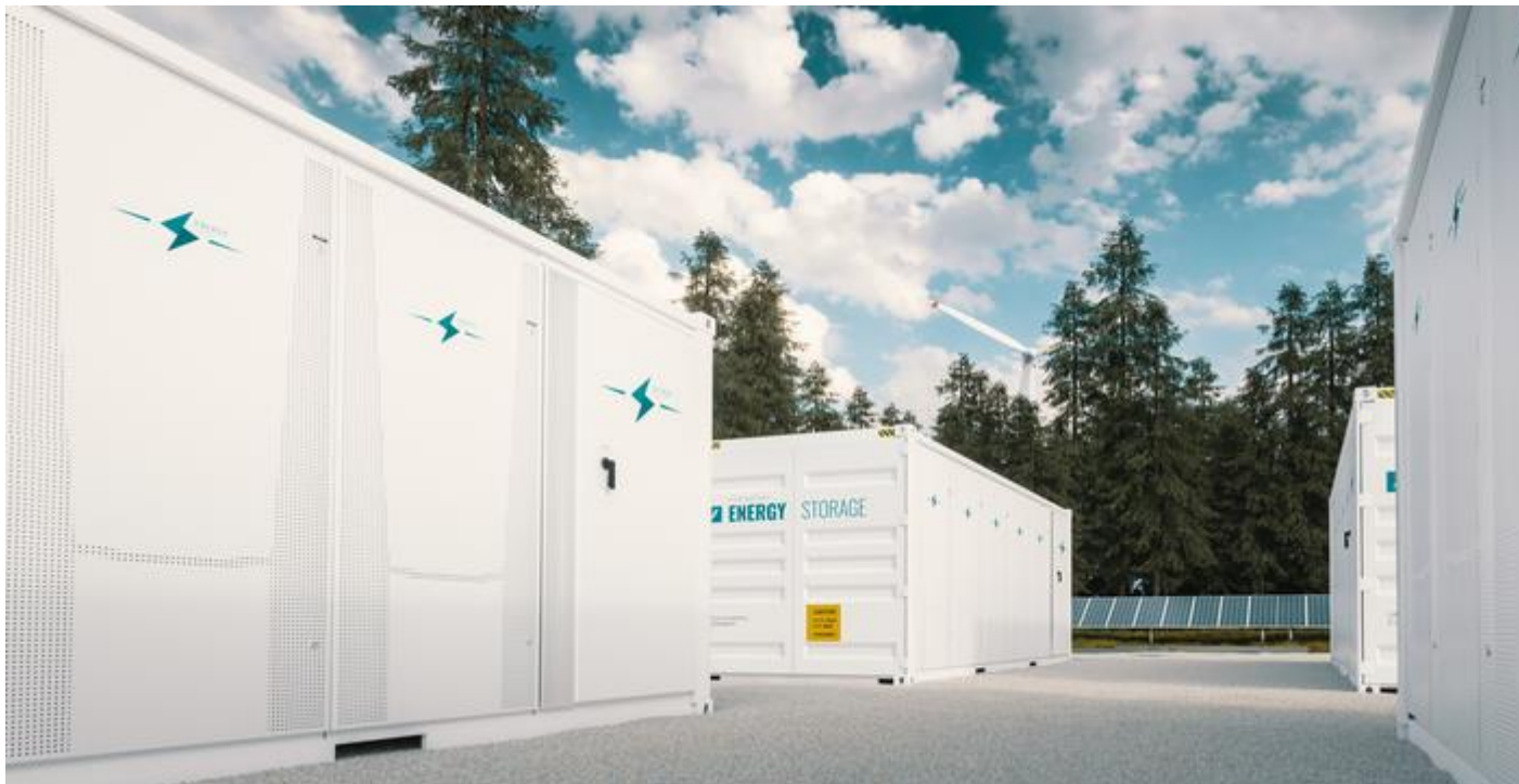
Energie Opslag Systeem
